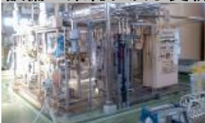
熱交換器(集約化後)
