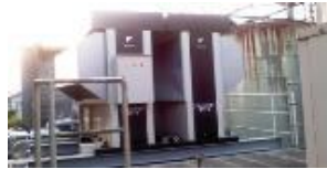
冷却チラー(更新後)
