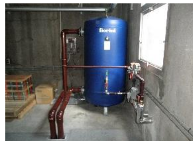
排熱回収装置の一部
